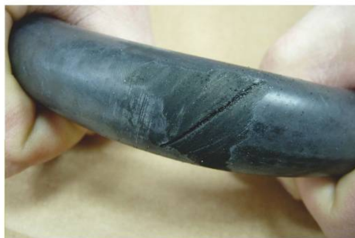
Fot-2 Przetarcie, przecięcie przewodu elastycznego. Miejsce to będzie źródłem ucieczki czynnika chłodniczego.
