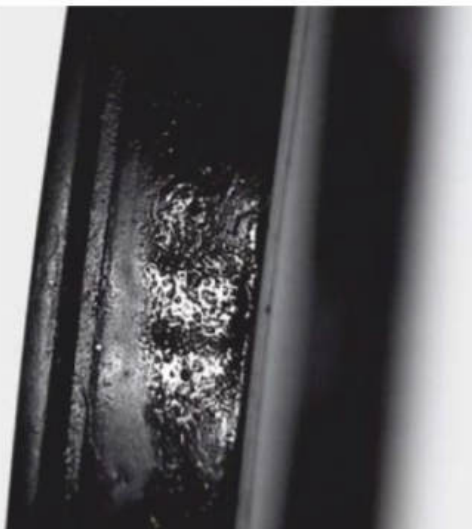
Zdjęcie 3 ... wypchnięta uszczelka ...
